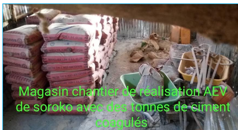
Photo 9 : Ciments coagulés et abandonné sur le chantier de réalisation de l'AEV de Soroko (Commune de Banikoara)
