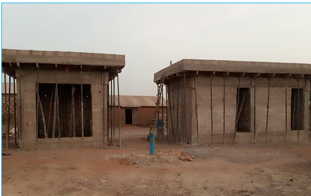
Photo 4 : Le forage et bâtiments devant abriter les salles de traitement de l'eau et le groupe à N'Dali
