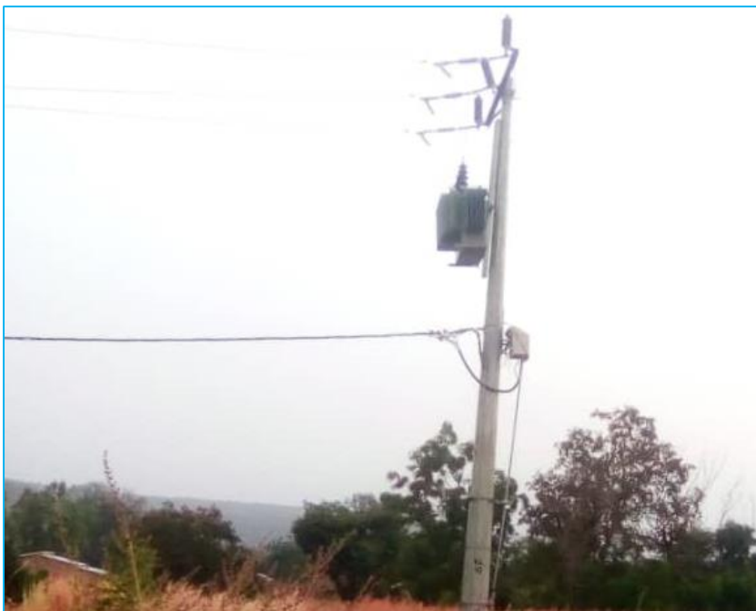
Photo 17 : Vue partielle du réseau électrique de Batia
