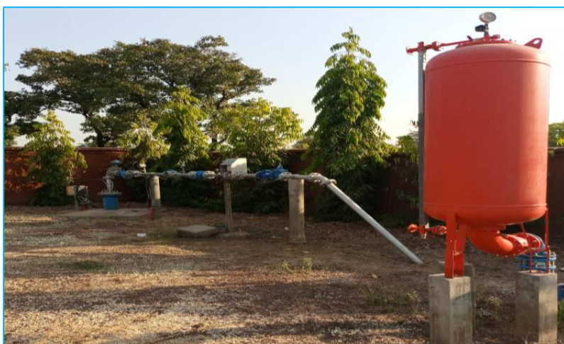
Photo 13 : Vue partielle (B) Forage de Bariénou
