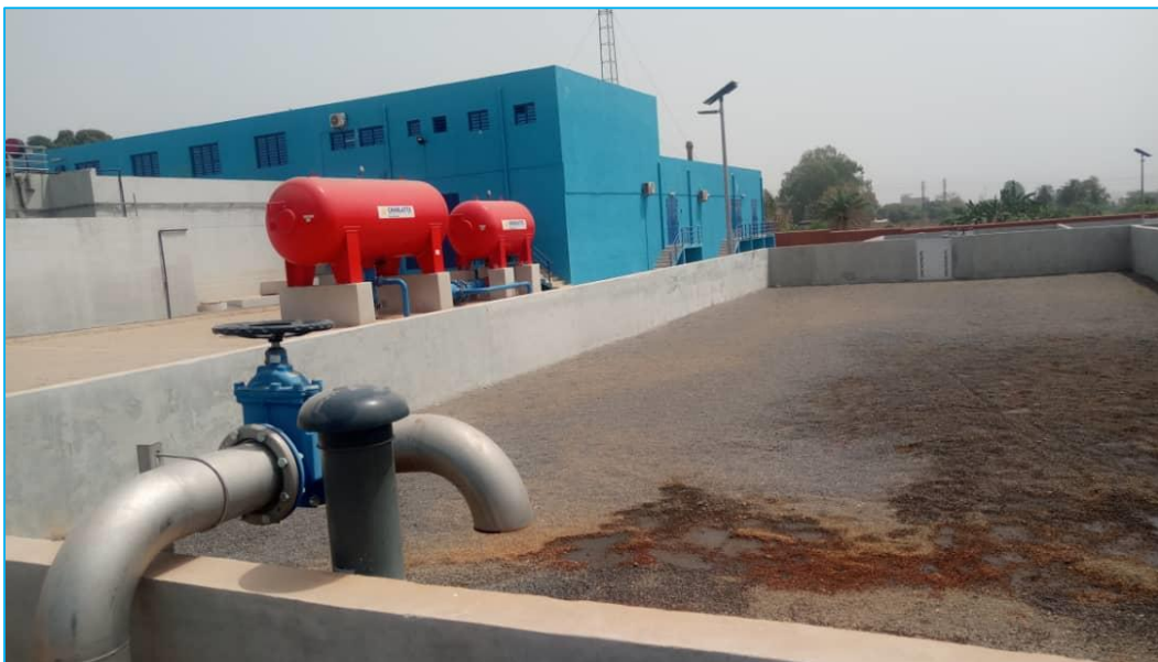
Photo 14 : Vue partielle du site du système d'alimentation en eau potable de la ville de Parakou et environs
