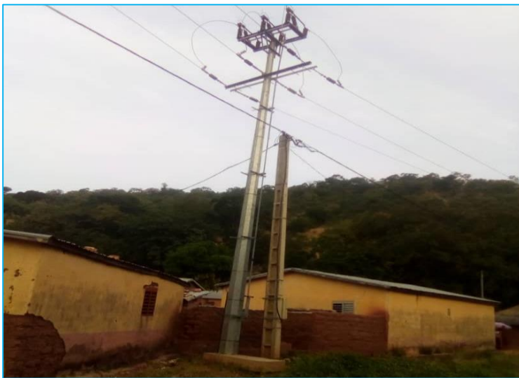
Photo 16 : Vue partielle du réseau électrique de Tanongou
