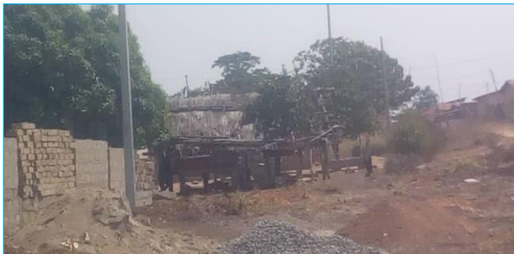
Photo 21 : Vue des Poteaux convoyés dans la localité de Gbonou, non installés et exposés aux intempéries
